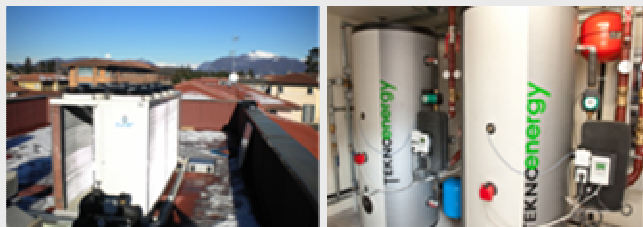
Casa Privata - Vista dal tetto con pompa di calore e vista locale tecnico con accumuli per ACS e climatizzazione
