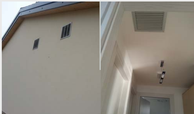
Vista esterna con particolare delle griglie di aspirazione ed espulsione
