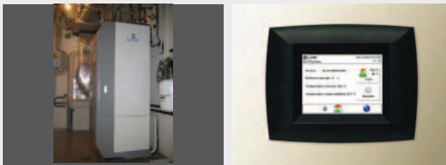
Частный дом – подвальное помещение с тепловым насосом и система централизованного управления.
