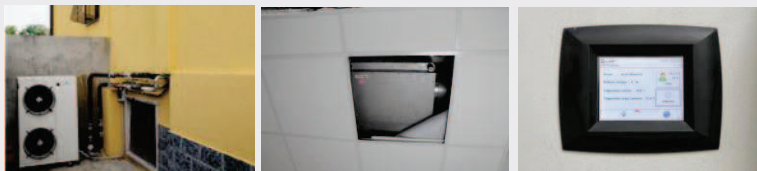
Жилой дом – Наружное размещение теплового насоса; блок для обработки приточного воздуха, смонтированный за подшивным потолком; система управления.
